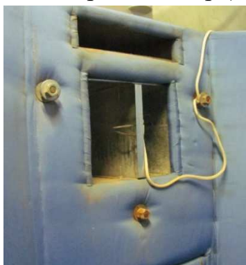
д) сверху горизонтальный канал вытяжки, ниже приточного газа (с датчиком) и канал рециркуляции
